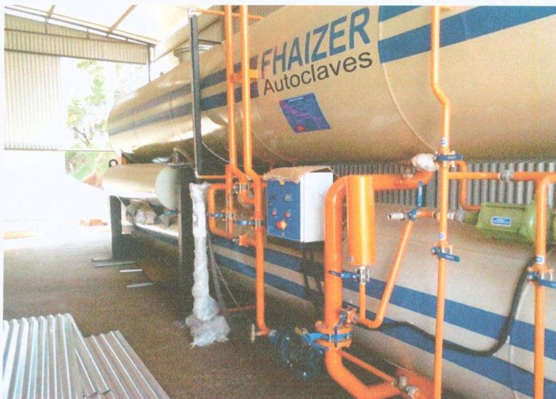
Figura 02. Usina de tratamento de madeira, com observação dos tanques de solução preservativa e quadro de comando.
