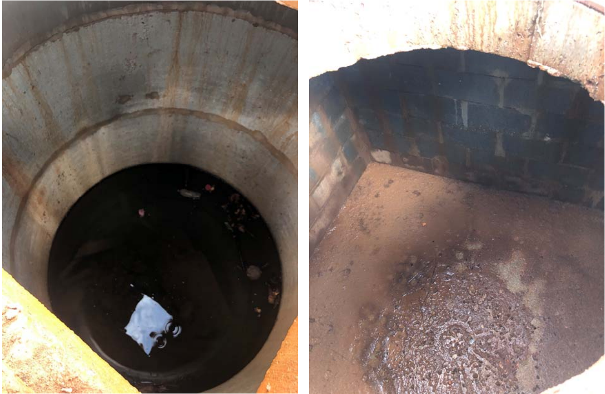
Fotos 53 e 54: Poço de sucção e barrilete - EE4
