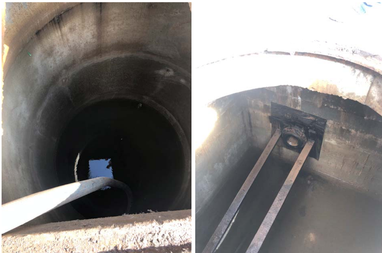
Fotos 49 e 50: Poço de sucção e barrilete - EE2
