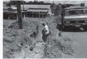
Comentários: Realização de detonação de rochas da rede coletora, com utilização de explosivos. Foto 02
