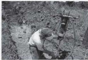
Comentários: Realização de detonação de rochas da rede coletora, com utilização de explosivos. Foto 01
