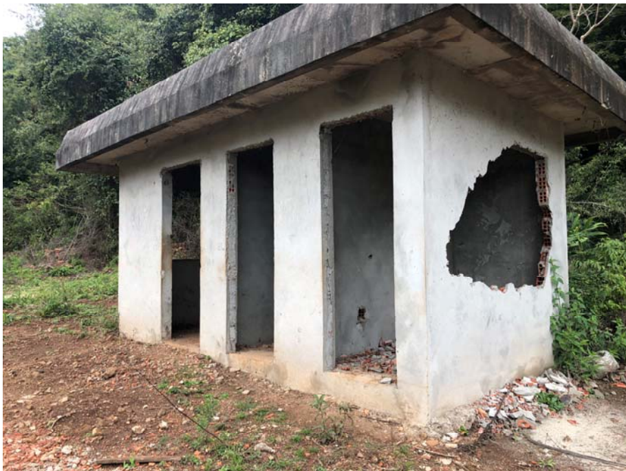
Fotos 58 e 59: Laboratório - Parte da estrutura depredada.
