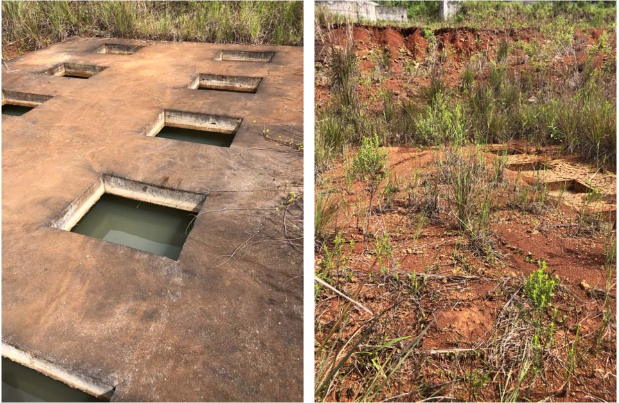
Fotos 76 e 77: Tanques de contato.
