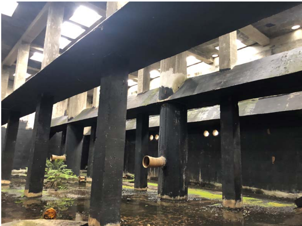
Fotos 67 e 68: Reator UASB - Ausência de materiais.
